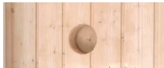
室内側から穴が空いた状態
